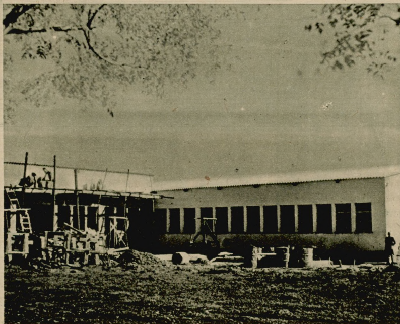
Vista das obras de melhoria e ampliação do pôsto situado em São Borja.
